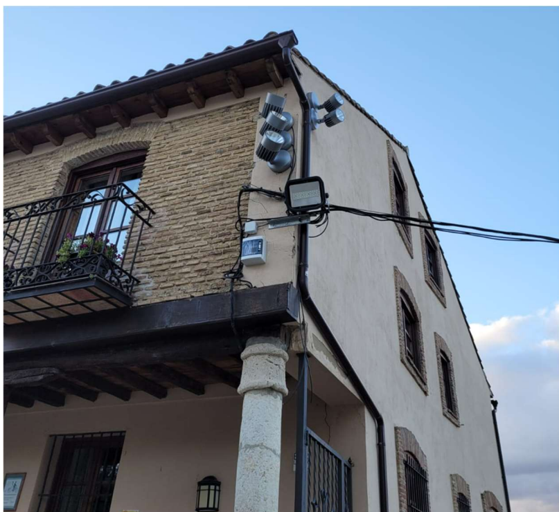
Proyectores instalados en fachada
