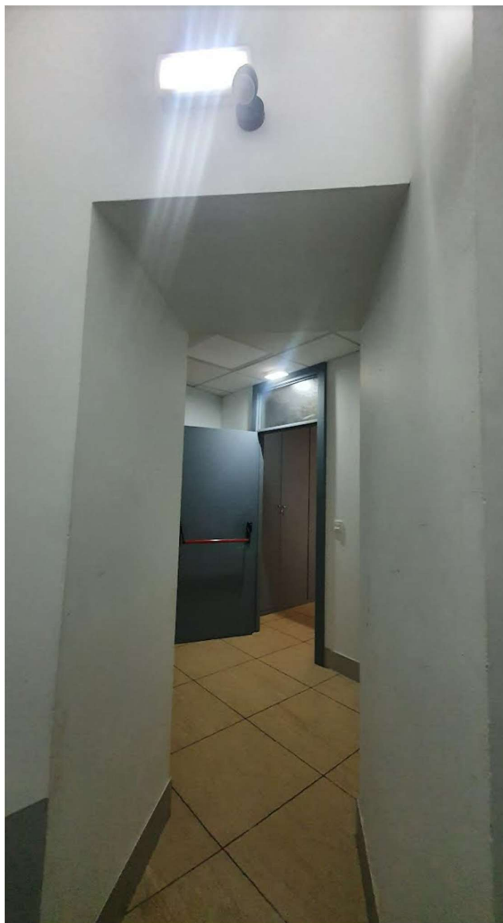
Luminarias de emergencia en ruta de evacuación
