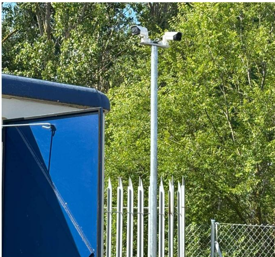
Cámara del sistema de seguridad y vigilancia
