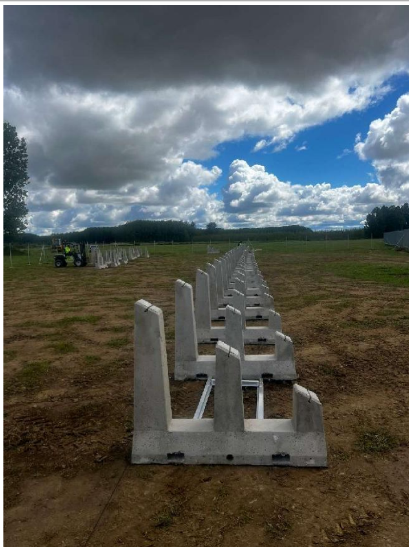
Soportes de hormigón para paneles solares
