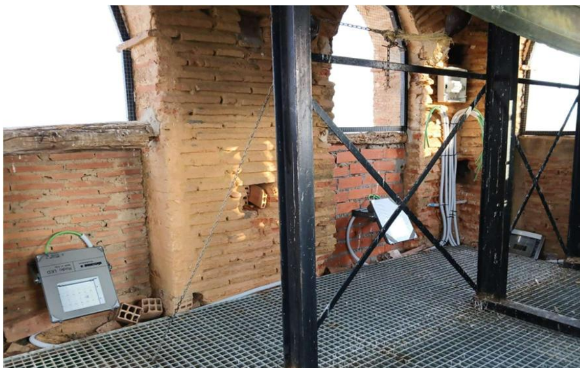
Proyectores y cuadro de control en campanario de Moratinos
