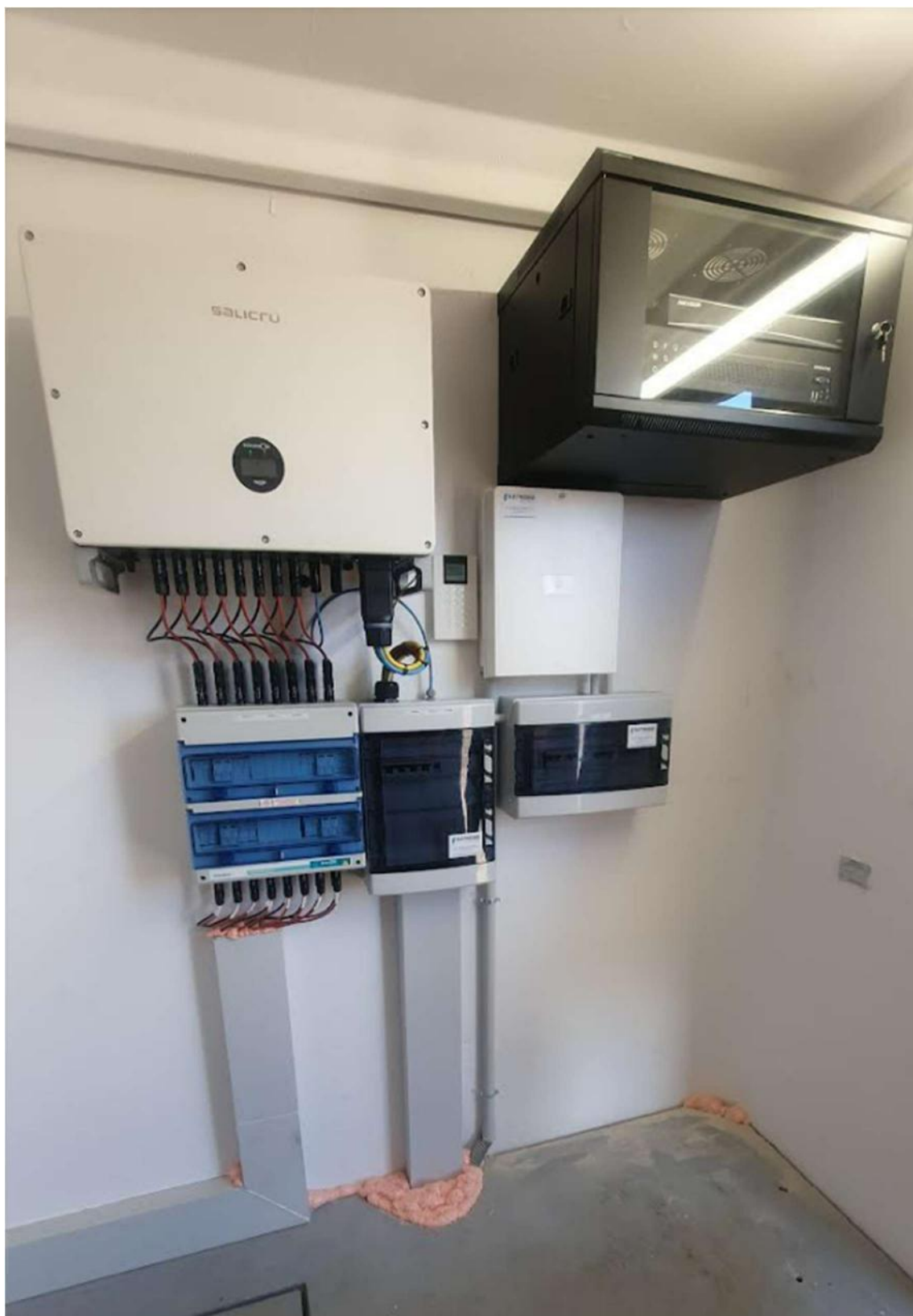
Inversor, central de vigilancia y cuadros de protección
