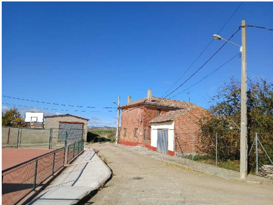
Nuevas luminarias viales en poste de hormigón
