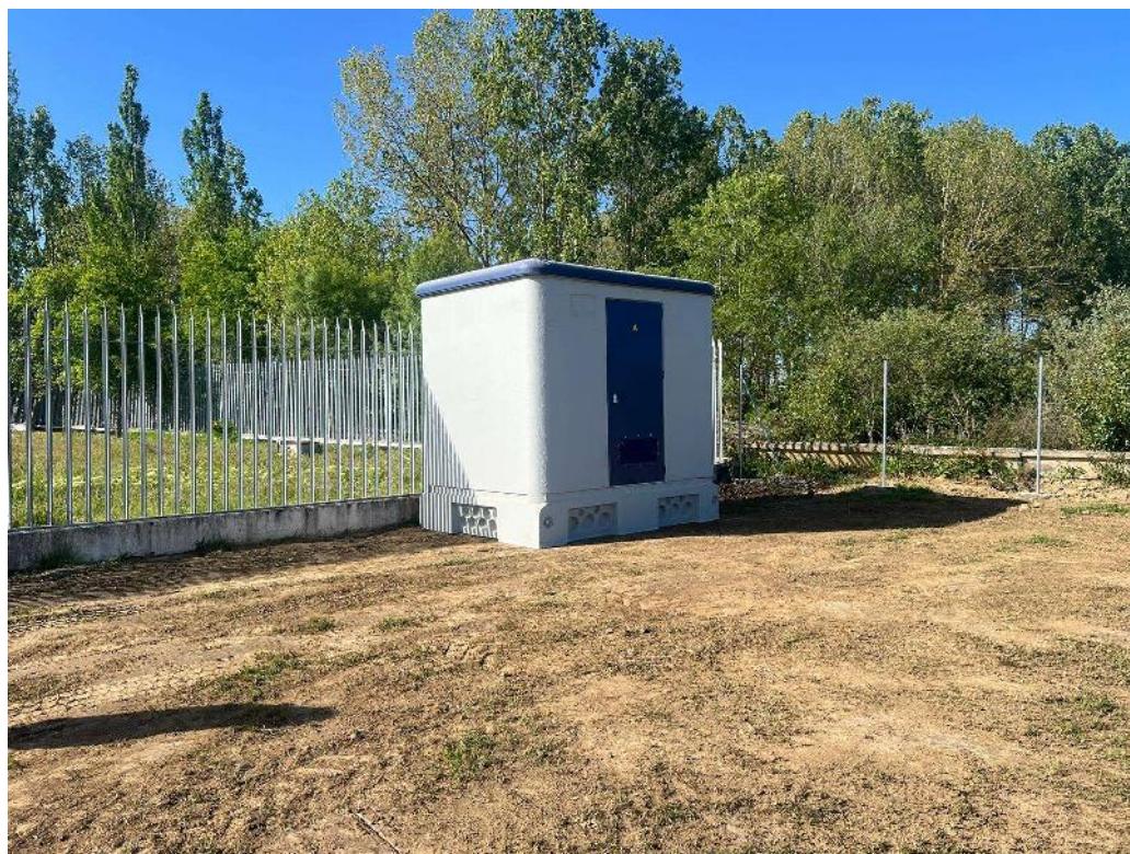
Caseta para instalación de inversores y cuadros de protección
