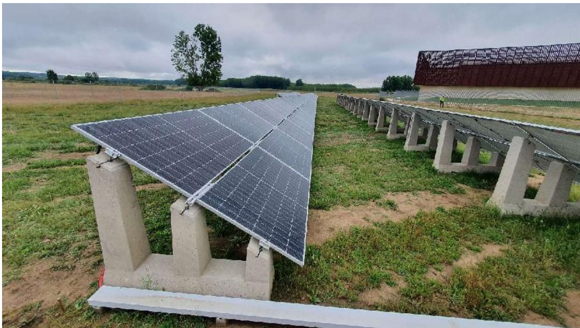
Conexión de strings de paneles solares
