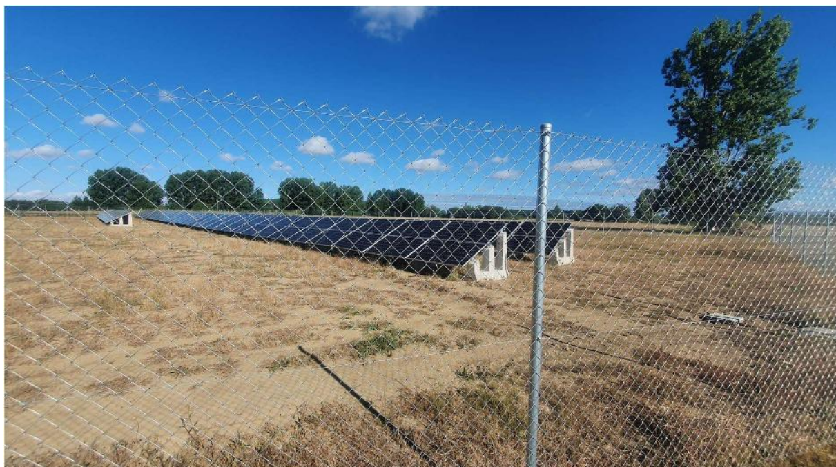
Campo solar terminado
