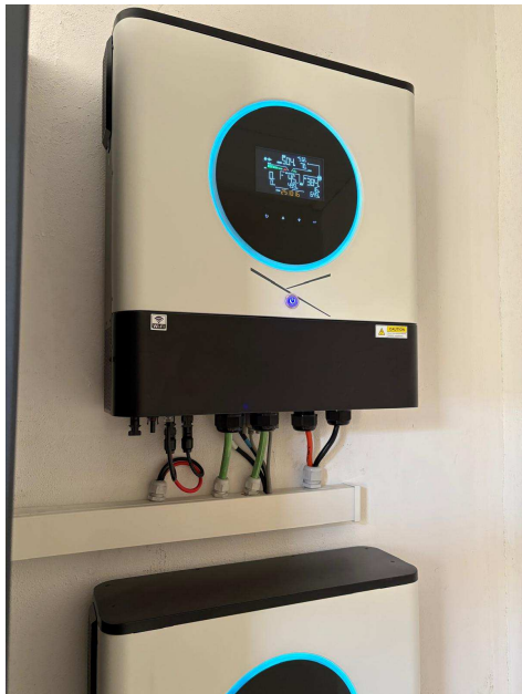
Cuadro eléctrico e inversor
