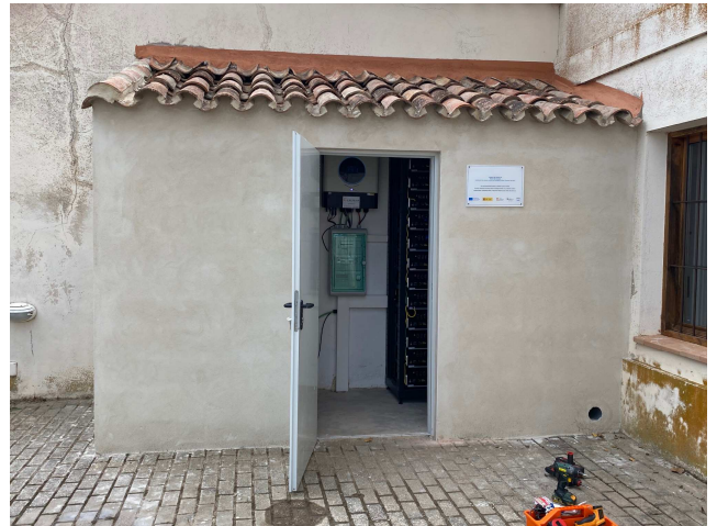
Caseta de equipos
