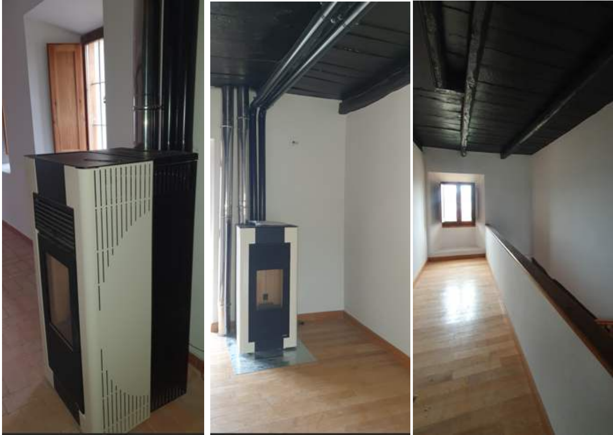
Calderas de biomasa en zonas comunes de planta baja y pta. primera.
