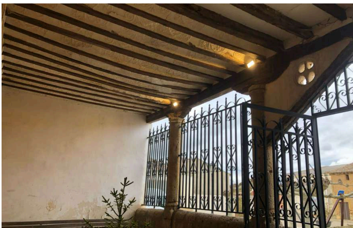
Ibero de Vega – Projectores en pórtico acceso
