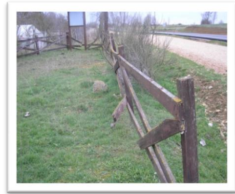
13.4 Situación inicial( Vallado deteriorado)
