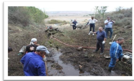
35.7 instalación de abastecimiento de agua
