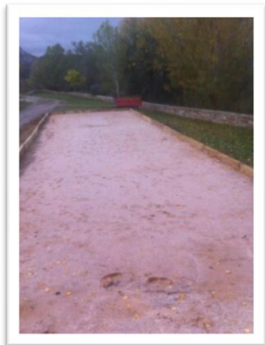
3.5. Compactación del terreno aladaño a la caseta. Formando la pista de bolos (Bolera)
