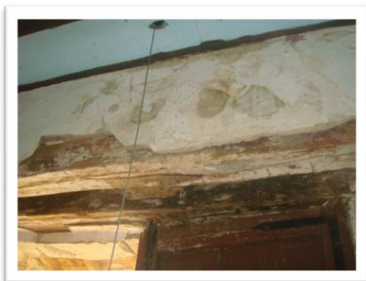
8.6 Estado de la viga de madera del tejado
