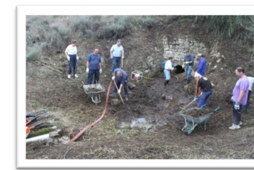
35.8 Instalación de abastecimiento de agua
