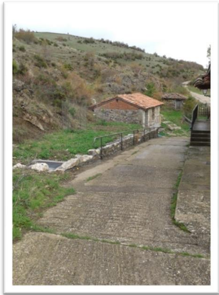
18.3 Con valla deteriorada
