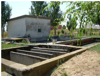
Ejemplo de una depuradora en estado de abandono
