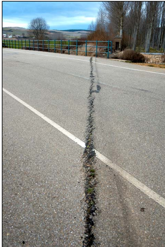
- FOTO 4 Detalle junta sin tratar en plataforma.
