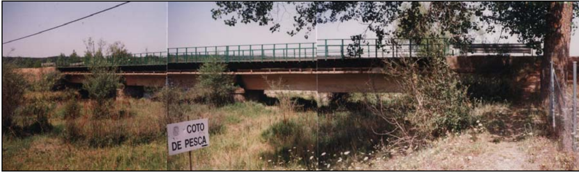
- FOTO 3 Vista general frontal del Puente y su entorno desde aguas abajo.
