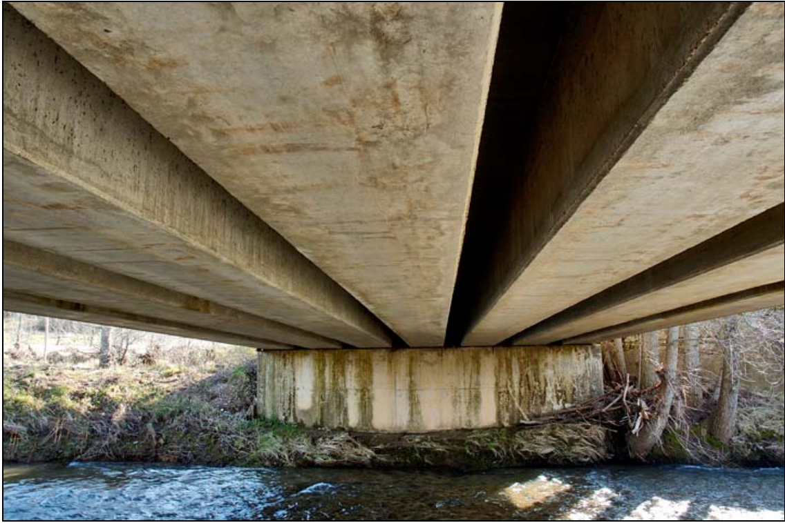
- FOTO 3 Detalle de las vigas vistas desde la parte inferior del tablero.
