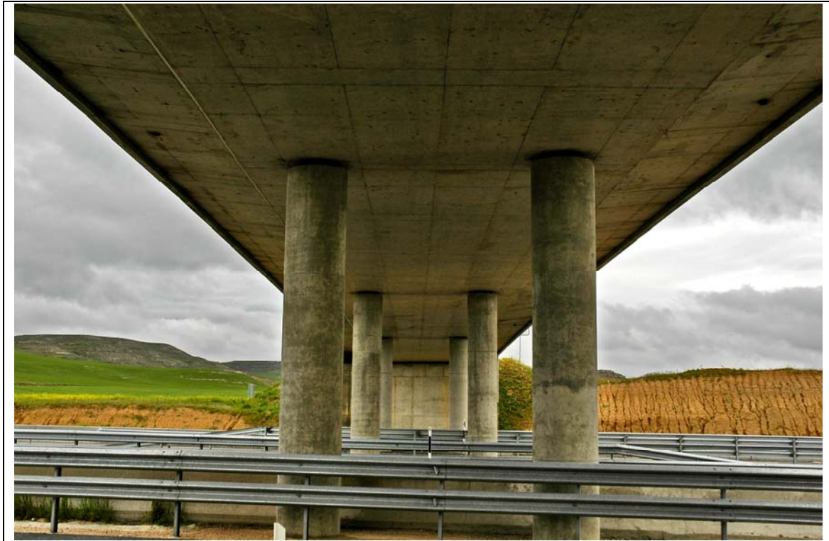
- FOTO 3 Detalle del la losa en su parte inferior.
