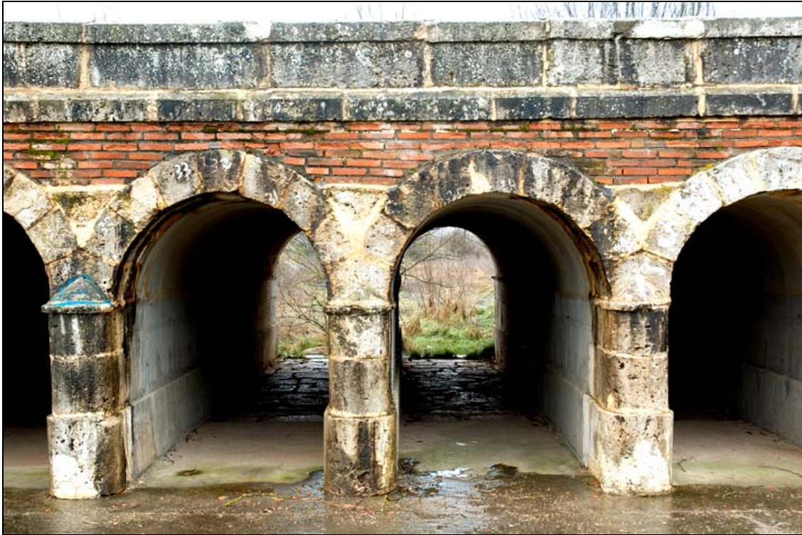
- FOTO 3 Hermoso detalle de albardilla, pretil, imposta, bóvedas de los arcos y tímpanos.
