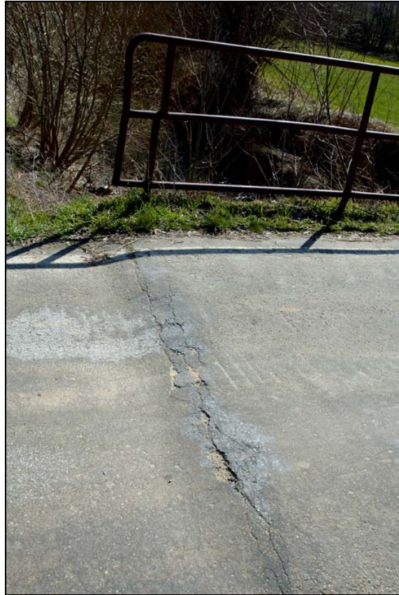
- FOTO 3 Detalle de una junta.
