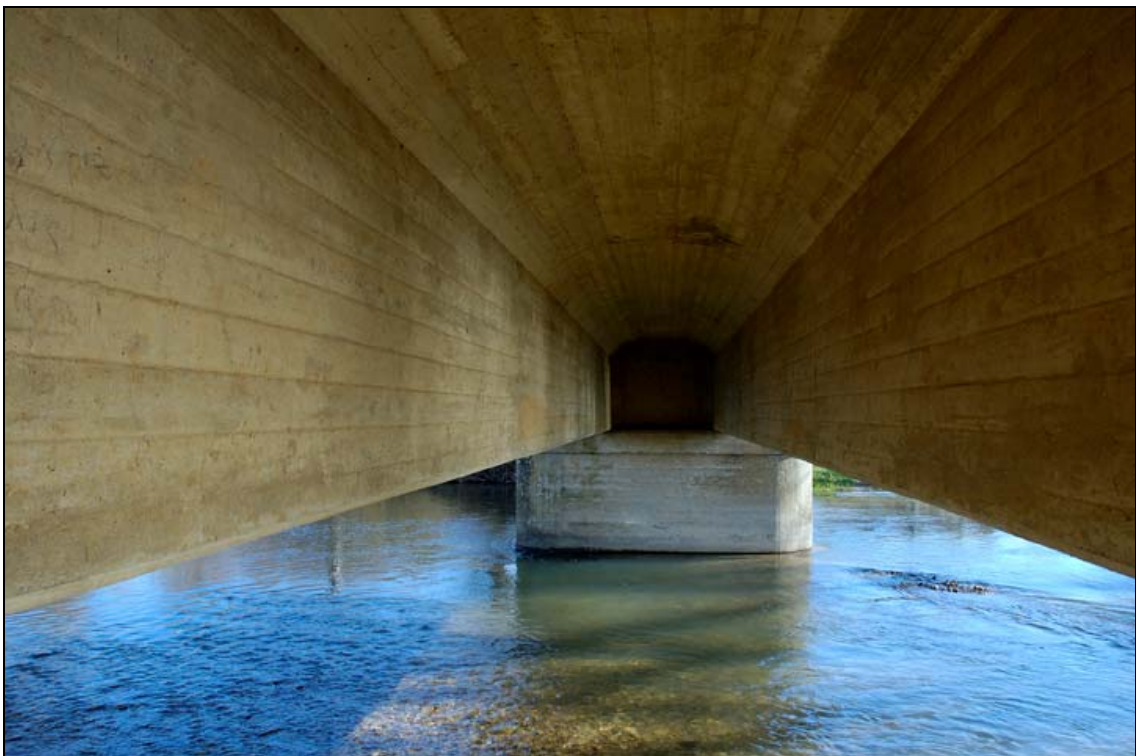
- FOTO 8 El interior de la viga.
