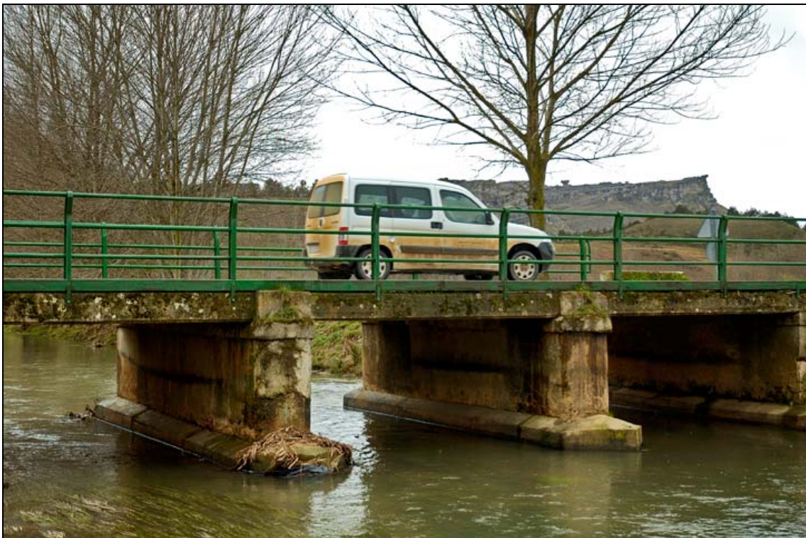
- FOTO 2 Detalle de los vanos con un vehículo pasando por la calzada del Puente.
