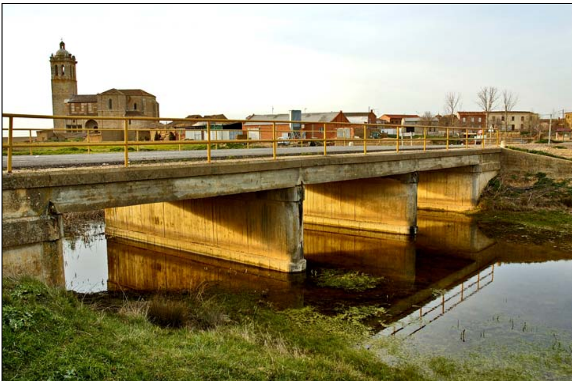
- FOTO 2 El Puente y al fondo el perfil de Baquerín de Campos.
