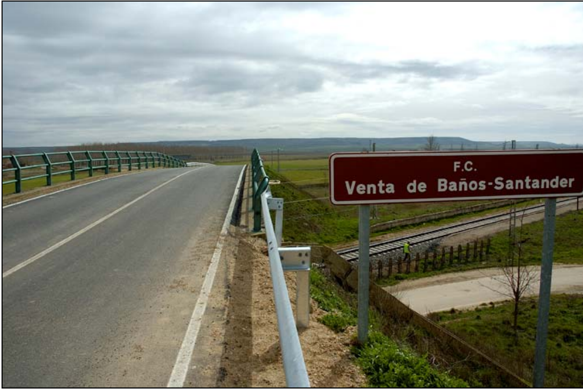
- FOTO 5 La planta y la señalización.
