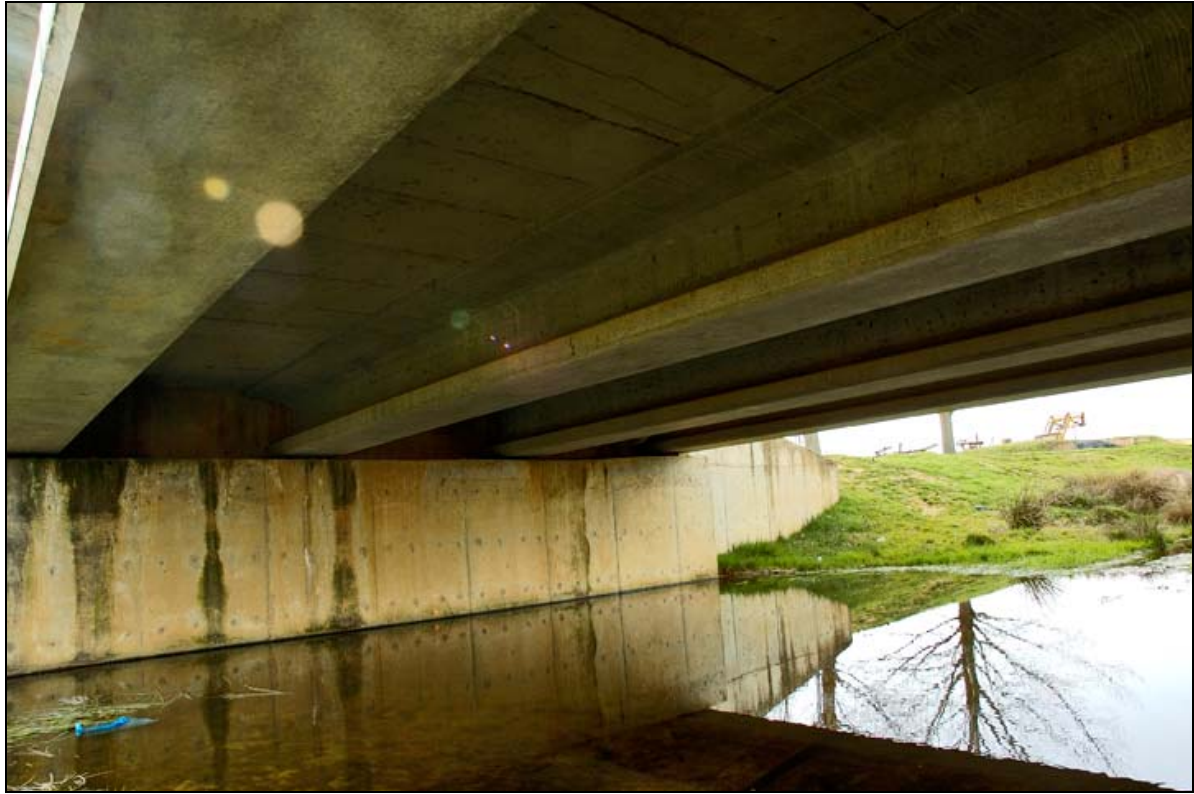
- FOTO 3 Detalle de apoyo de las vigas en uno de los estribos.
