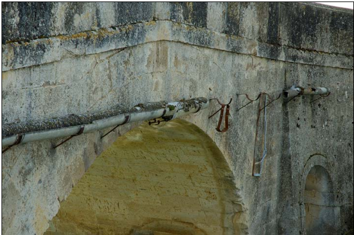
- FOTO 4 Detalle de restos de instalación en uno de los paramentos del Puente.
