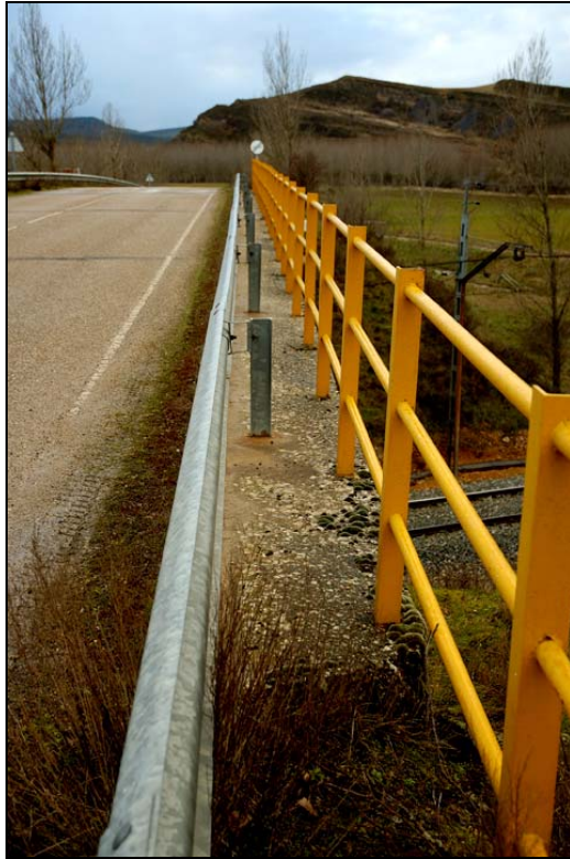
- FOTO 7 Detalle de la barandilla y la banda bionda de la calzada.
